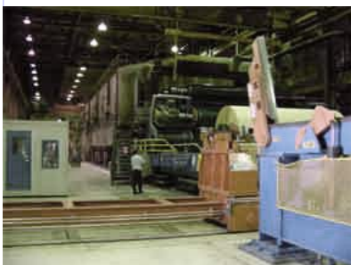
Machine dans l'usine Kruger Wayagamack (Trois-Rivières, Québec) : partie sèche.
